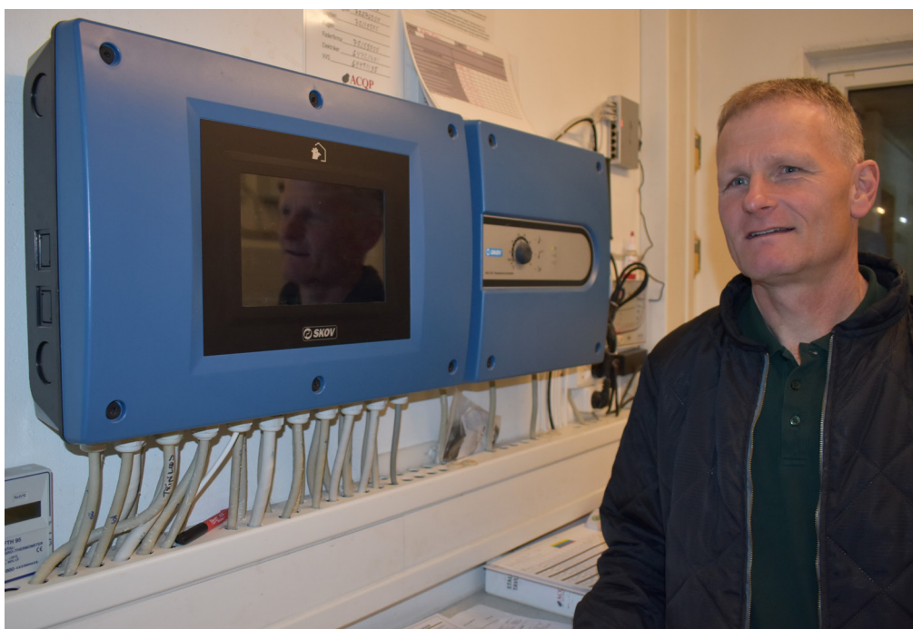
Claus Bjørn foran computeren, der styrer det hele. Her kan Claus f.eks. regulere temperaturen i husene, så det passer til gårdkyllingernes alder. Der er automatisk styrede vægventiler samt varmeveksler i husene. Foto: Henning Laen Sørensen
